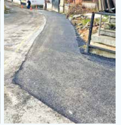
Aydınli Mahallesi Köy İçi Transe
